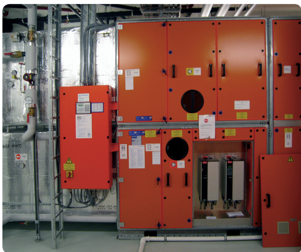
Fig. 232 Moderne ventilasjonsaggregat med frekvensregulator for turtallsstyring og målestasjon. Foto: SINTEF Byggforsk
